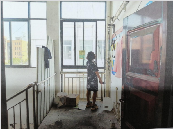
该厂原料调配、生产加工区域多处存在门窗未密闭现象
